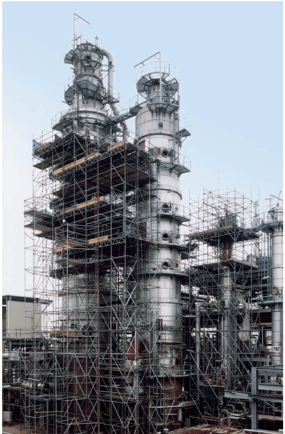
▶ Zwei Kolonnen DN 5600 und DN 3800 während der Umrüstung auf Montz-Pak
